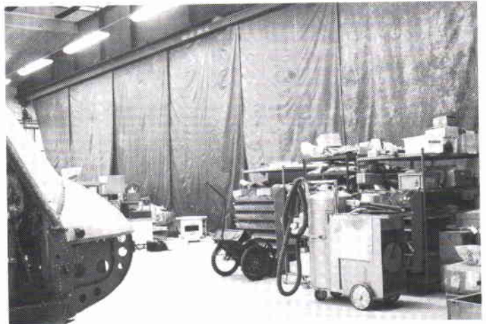
Vid en ombyggnad i flygverkstaden kan en vanlig tät plastfolie möjliggöra fortsatt arbete i lokalen. Men man måste se upp ändå.
